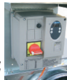
Coffret de régulation
